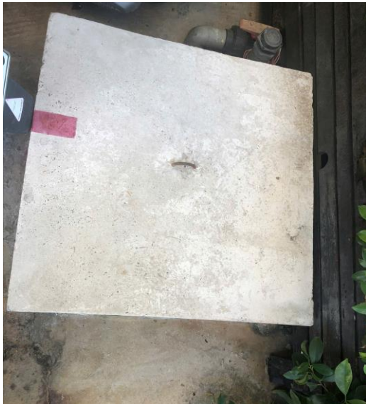
Hình 3.8. Bể tách dầu mỡ
