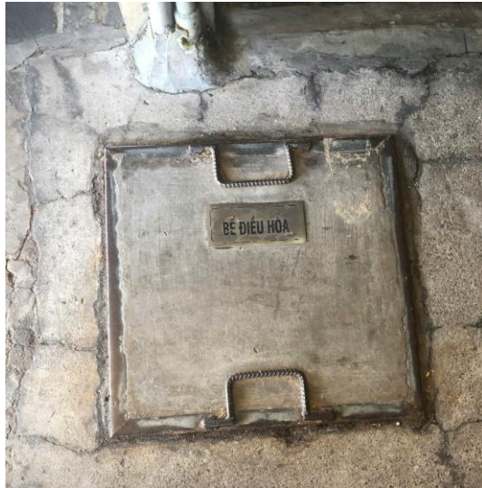
Hình 3.7. Bể điều hòa
