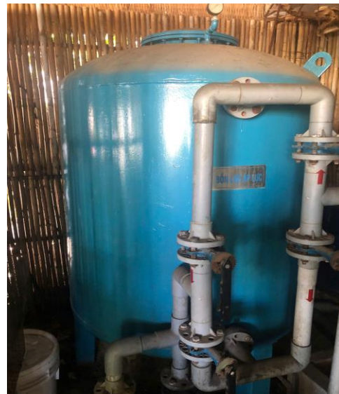
Hình 3.9. Cột lọc áp lực
